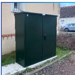
Armoire de rue
